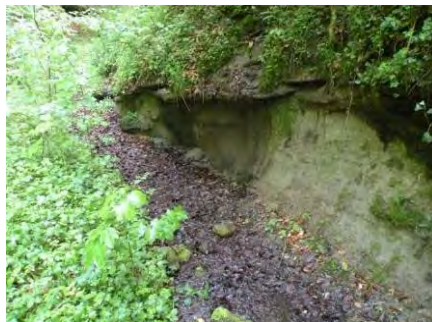
Wasseraustritt aus Sandstein
